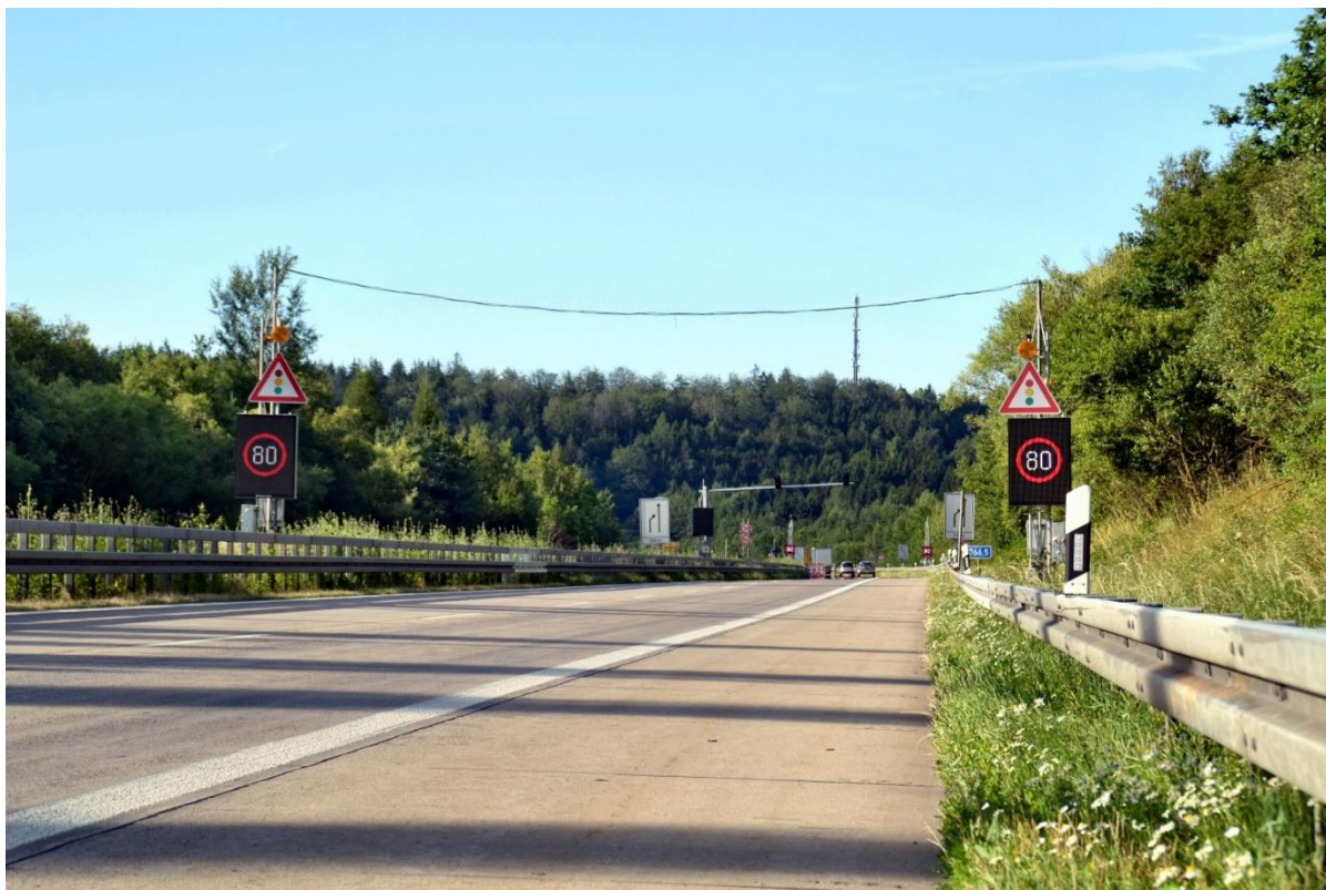
Abbildung: Tunnelsperranlage Anzeigequerschnitt mit Wechselverkehrszeichen und Lichtsignalanlage (Quelle: Green Way Systems GmbH)
