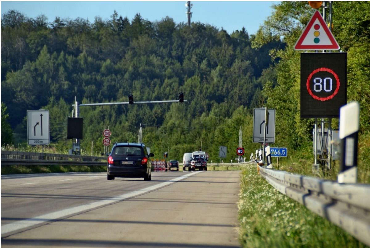
Abbildung: Tunnelsperreinrichtung Anzeigequerschnitt mit Wechselverkehrszeichen und Lichtsignalanlage (Quelle: Green Way Systems GmbH)
