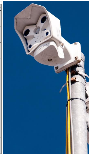
Photo 3 : matrice de de la logique de commande des PMV, dans le sens vers Stuttgart. Webcam à double optique sur pylône.
